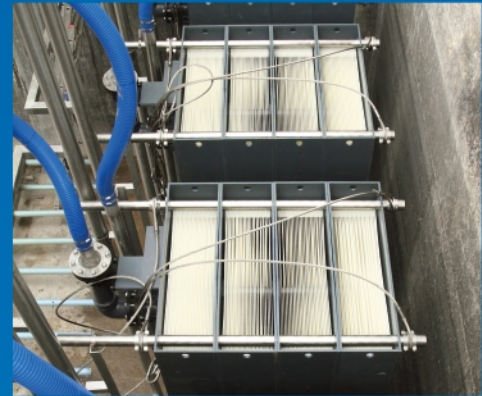
Instalace membránových modulů
