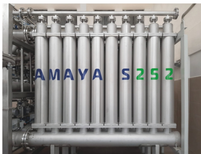
Klenovec WTP (SK)
