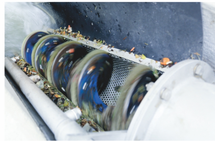
Strojně stírané česle
